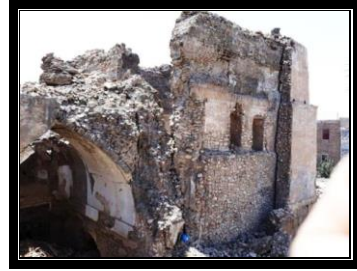
الصورة (٢٠) بقايا البناء بعد التفجير
